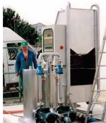
Raccordement, unité de dépollution d'eau usées résiduares
