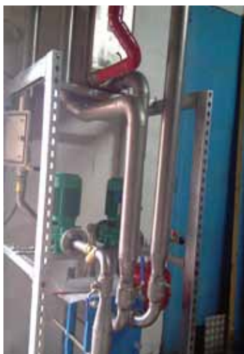
Raccordement échangeur sur réseaux tuyauteries
