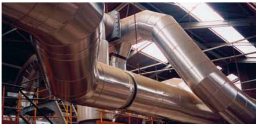
Gaines de ventilation calorifugées d'un four dans une briqueterie/tuilerie
