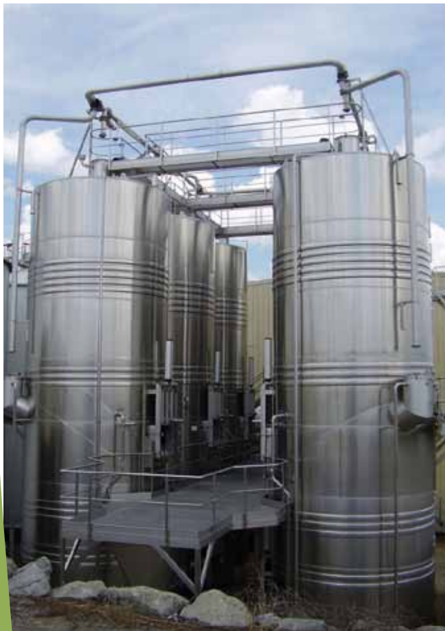
Ensemble cuves et tuyauteries
