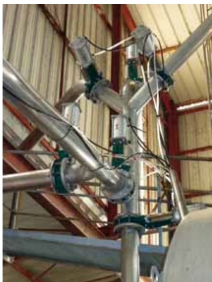
Fourche de répartition en DN 150 avec vannes guillottes motorisées
