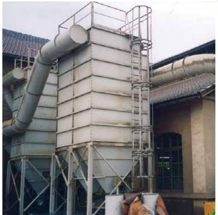
Silos et gaines de dé poussiérage sur unité de broyage - concassage et transport de matériaux
