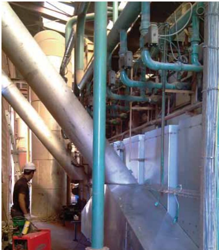
Goulotte (en inox) d'évacuation des fumées et odeurs de four
